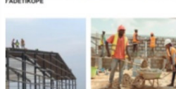
FOURNITURES DE RESSOURCES HUMAINES ET MATÉRI SUR LE SITE DES TRAVAUX DE LA PLATEFORME INDUSTR D'ADETIKOPE
